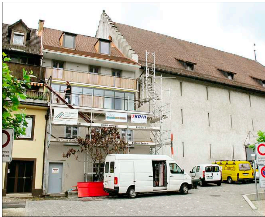
Das Haus «Hofstatt 23» grenzt unmittelbar ans Salzhaus; verschiedene Handwerker sind im Moment noch an der Arbeit Bild: pbe
