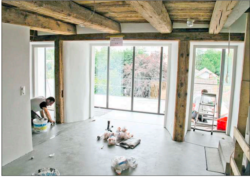
Der grosszügige Gemeinschaftsraum geht direkt über in die Terrasse; Handwerker sind mit letzten Arbeiten beschäftigt
