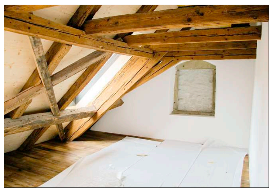
Die Balkenlage im Dachstock wurde ergänzt und saniert; das von der Salzhaus-Wand zugemauerte Fenster als Merkwürdigkeit belassen Bilder: pbe
